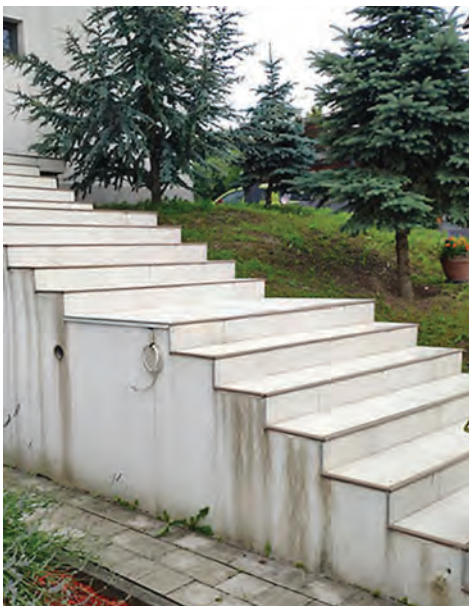
Izgled stepenica prije sanacije
