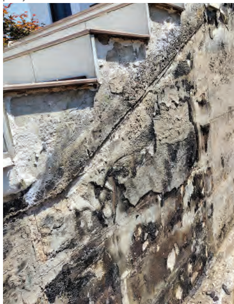
Vidljiva bočna oštećenja stepenica kao i prodiranje vlage ispod postojeće keramike
